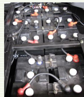
controleer de accupolen regelmatig en houdt deze corrosievrij
