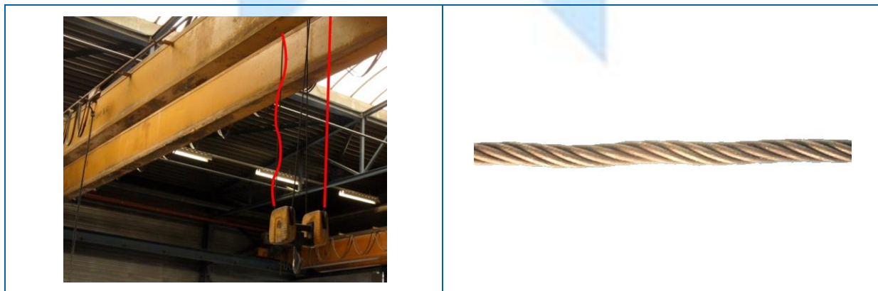
Afb. 4-4 Spiraalvorming (links) en detailfoto van een staalkabel met spiraalvorming
