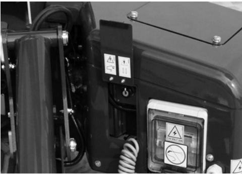
Fig. 126 Aansluitdoos in ruimte met elektrische componenten.
